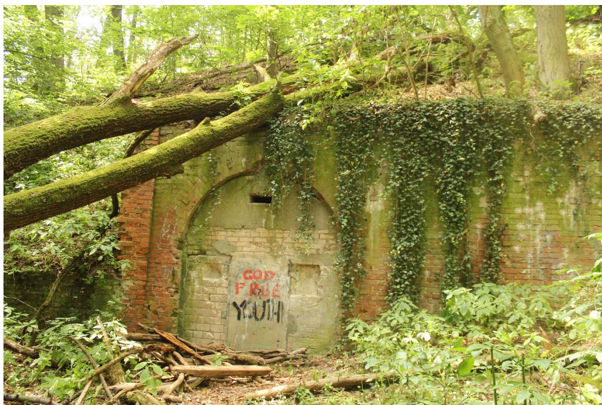
Abbildung 13: Zugemauerter, für Fledermäuse zugänglicher Kellereingang unter der Alten Veste
